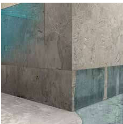
Проникновение воды через рабочий шов бетонирования
